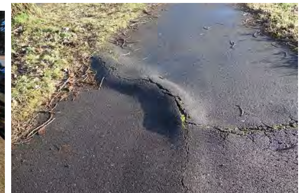
Racines d'arbres — inconfort voire chute.
